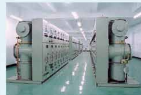
23~161 kV GIS 設備
