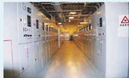
高低壓配電盤
